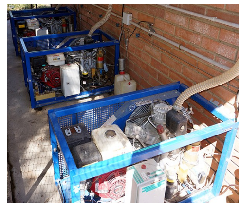
Compressor d'èmbol en un parc bombers. 3 etapes 300bar 500l/min. Motor gasolina Foto de l'autor
